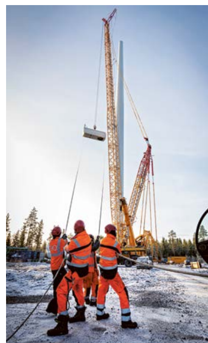
Projekt "Castles" (107,4 MW) i Finland byggdes 2019. Investerare INGKA. Foto: Joachim Lagercrantz.
